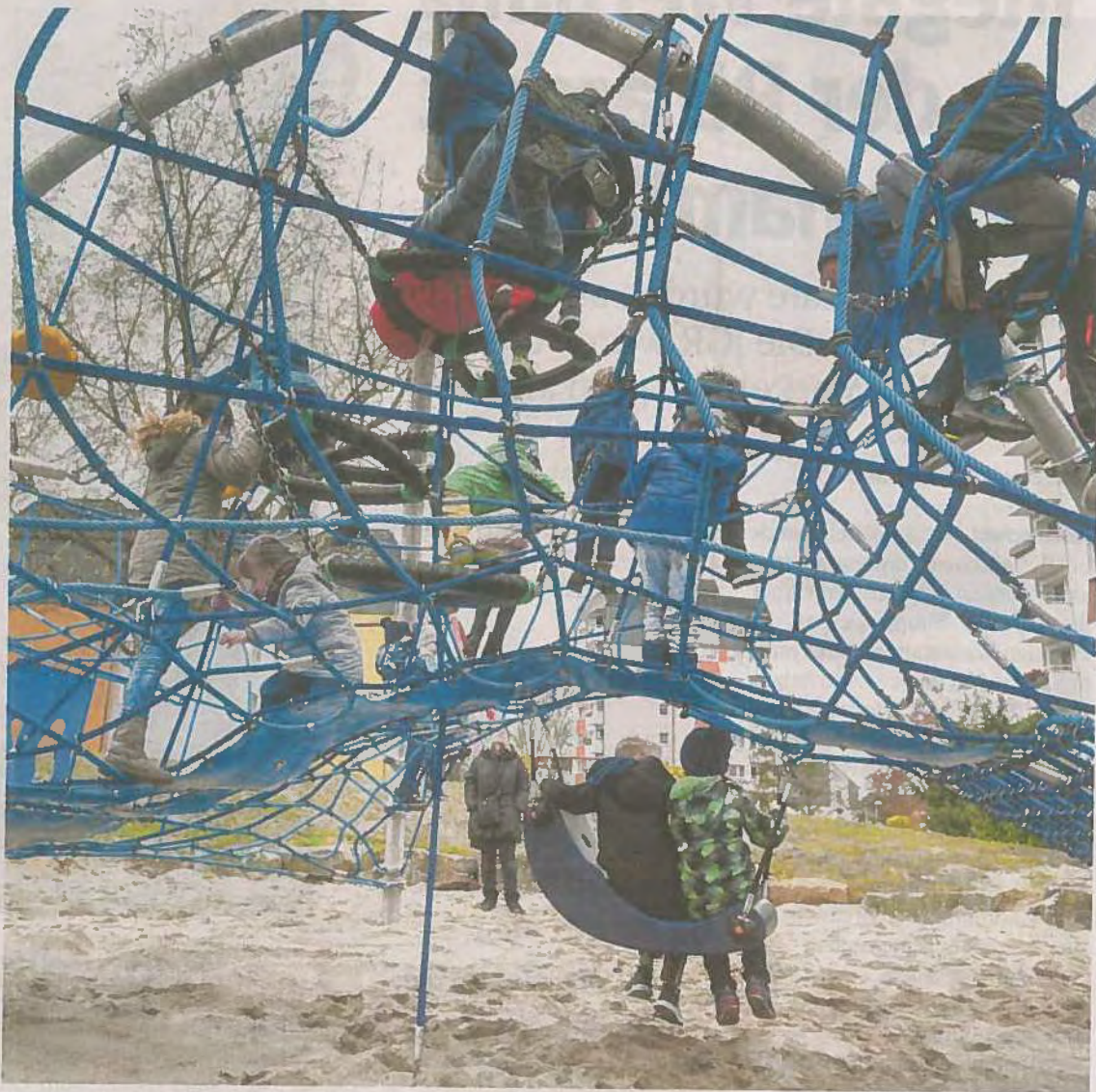
Der Untergrund wurde zunächst aufgearbeitet, dann konnte das Spielgerät auf dem Areal an der Borkumstraße mit seinen Seilen, Brücken und Rutschelementen fest installiert werden.
