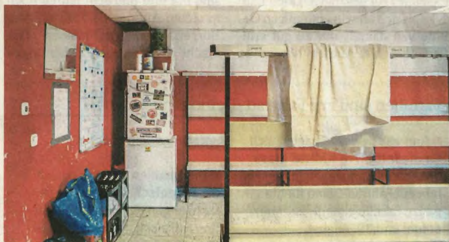
Die maroden Kabinen werden im Zuge der Sanierung komplett umgebaut und neu aufgeteilt.
