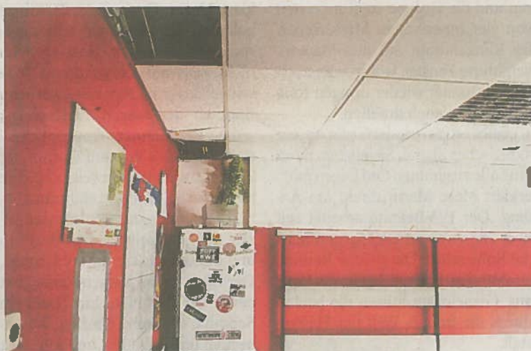
Die Umkleiden beim Tusem weisen etliche Schäden auf und genügen auch optisch nicht den aktuellen Ansprüchen.
